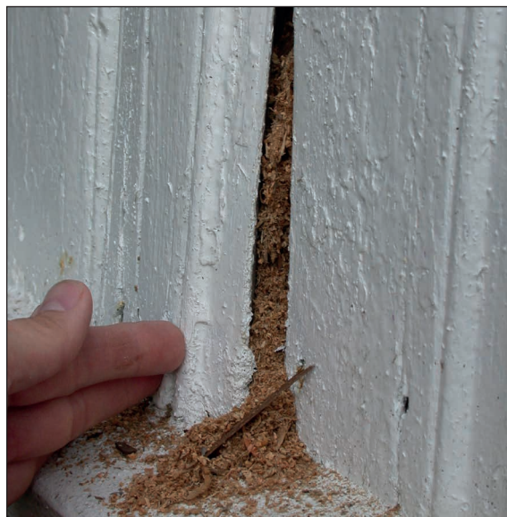
UTFORDRINGER Istandsetting av gamle bygg, mange også med vern, er utfordrende. Stokkmaurangrep på Ytre Vassholmen i 2002.
